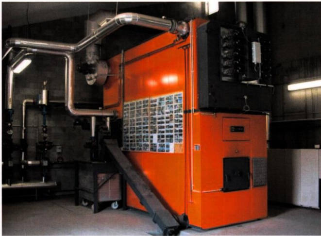
La chaudière Schmid de 1,2 MW à Tramayes, photo FD
